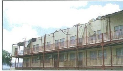
L'école primaire de Desmarinières dont la toiture est fortement endommagée
