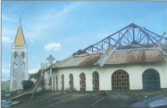
La toiture de l'église de Grand-Bourg n'a pas résisté à Dean
