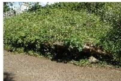
Glissement de terrain
