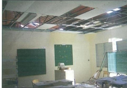
La toiture de l'école primaire de Fonds Masson partiellement détériorée
