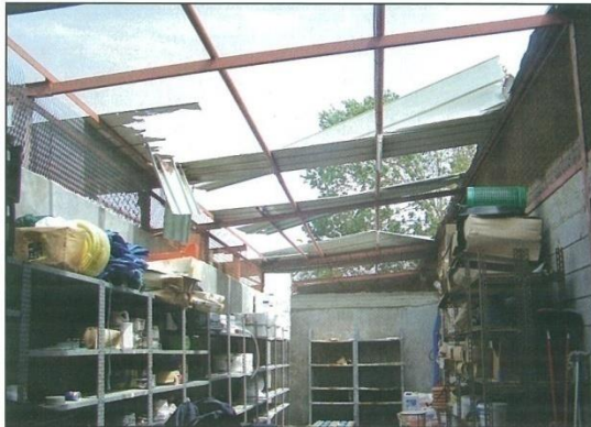
L'atelier de stockage des services techniques municipaux n'a plus de toit
