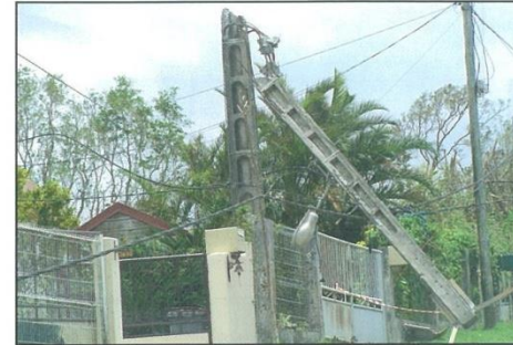
Un pylône électrique cassé sous la force des vents
