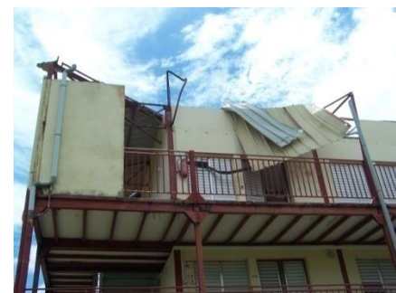
Dégâts sur L'école primaire (Toiture arrachée)
