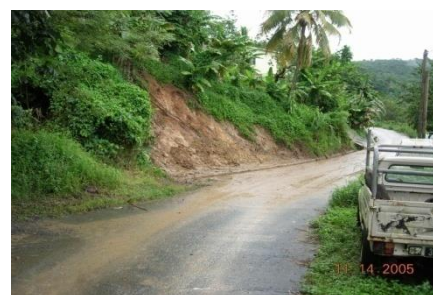
Coulée de boue
